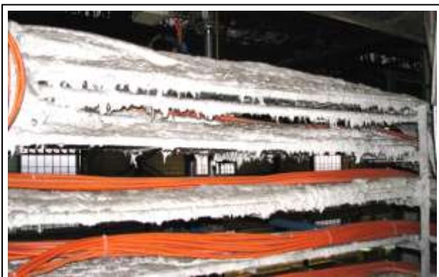
Na obrázku jsou pod požárním nástřikem původní kabely, oranžové kabely jsou již nehořlavé typy, položené při obnově zařízení.
